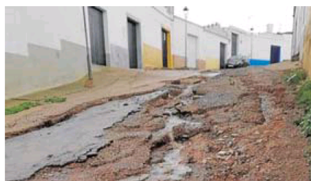
Destrozos del agua en la calle Pilitas. JOSÉ DE LA CRUZ
