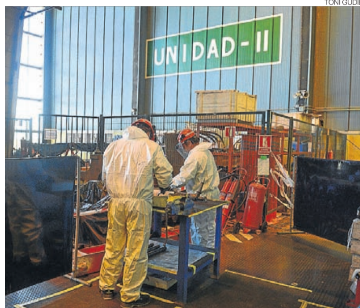
► Dos operarios trabajan en el interior de la central nuclear de Almaraz.
