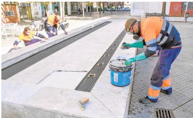
Las reparaciones se han realizado en la plaza del Hermano Daniel, que está en María Auxiliadora. C. MORENO
