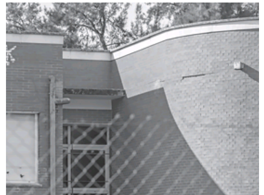
Patio del instituto que se ha vallado por las fisuras. :: J. V. ARNELAS
